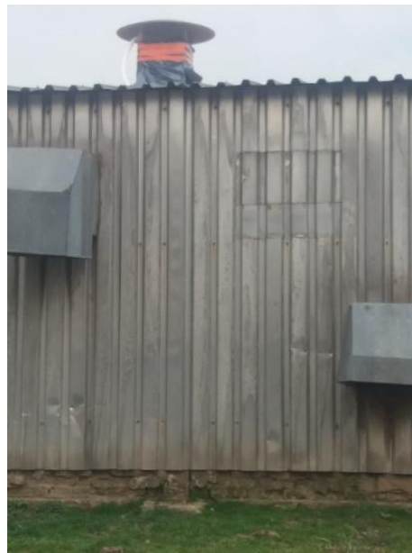
Obr. č. 13 - Utěsnění výparníků
